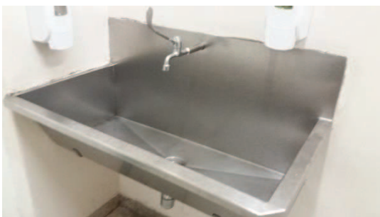
Fig.125 – Local de ponto de coleta 10: Lavatório Cirúrgico/Escovação Fonte: Autora, 2016.
