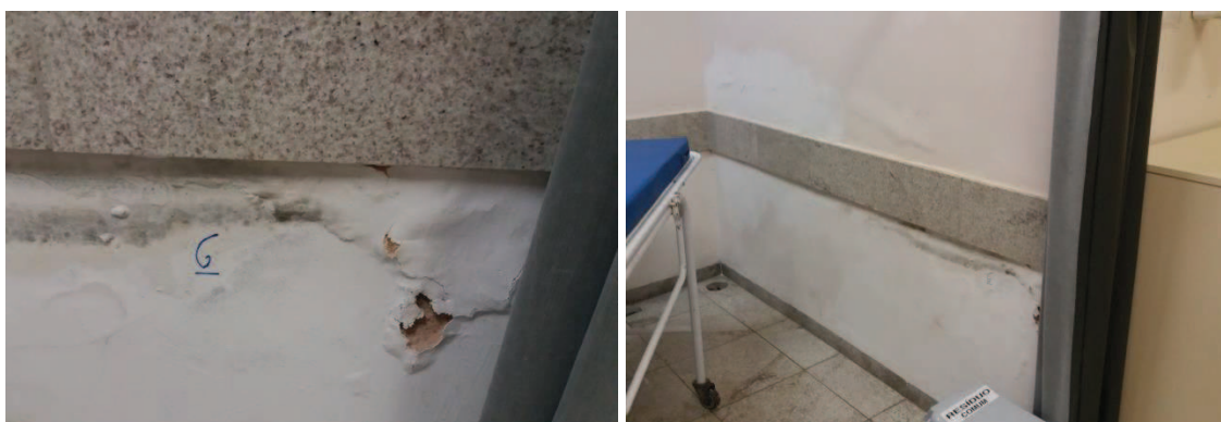
Fig.160 – Infiltração ascendente na parede da sala de pré e pós operatório (antes – foto já apresentada) Fonte: Autora, 28 de setembro de 2016.
