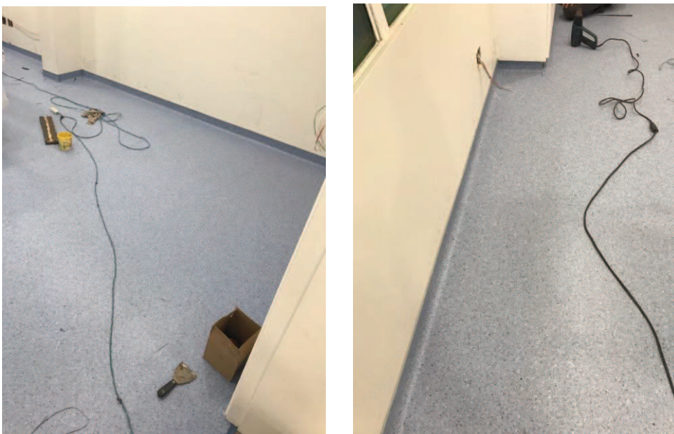
Fig.156 – Assentamento do piso vinílico em manta na sala de exames após impermeabilização do contrapiso. Detalhe do rodapé arredondado como pedido na legislação.
