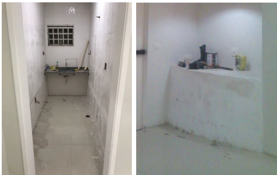
Fig.172 – Instalação da bancada da copa e Construção da bancada do café da recepção Fonte: Autora, 27 de abril de 2017.
