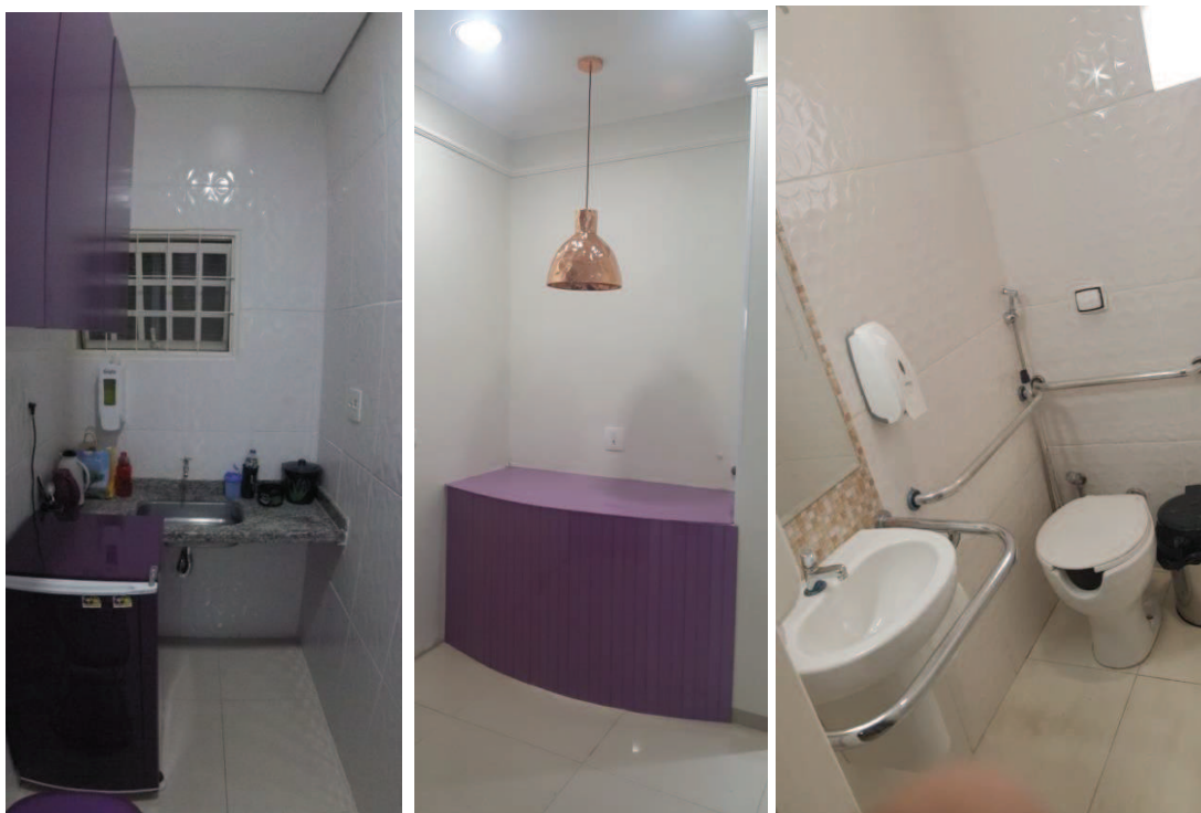
Fig.178 – Bancada da copa (granito impermeabilizado). Bancada do café da recepção. (tampo em vidro lilás. Lateral: lâminas de vidro lilás instaladas com silicone para fácil assepsia). Banheiro P.N.E. com a cuba e coluna suspensa. Vaso sanitário especial e todas as barras de apoio (NBR 9050) (Finalizando obra).
