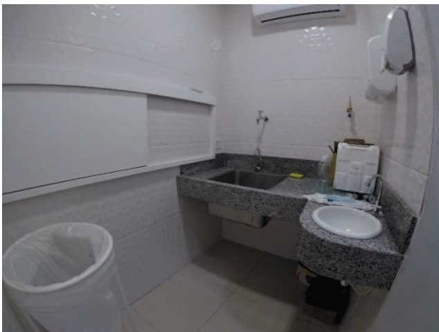
Fig.236 – Expurgo. A esquerda vê-se a janela de acesso à Sala de exames. Ao fundo, pia de inox profunda para higienização de materiais, e a direita pia para higienização das mãos. Fonte: Autora, 2018.
