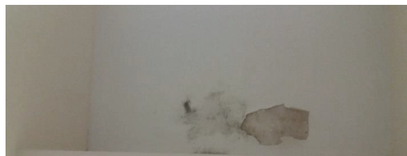
Fig.126 – Detalhe do teto sobre ponto de coleta 10. Infiltração. Lavatório Cirúrgico/Escovação Fonte: Autora, 2016.
