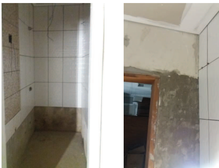
Fig.179 – Foto da esquerda: Instalação dos revestimentos nos banheiros. Foto da direita: Instalação do revestimento no expurgo.
