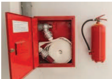
Fig.13: Hidrante e Extintor de incêndio Fonte: http://araujoprojeto.com.br
