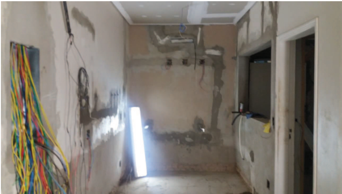
Fig.163 – Imagem fotográfica da retirada e reconstrução do reboco com impermeabilizante há 1m do piso para prevenir a infiltração ascendente. Também foram retiradas e refeitas algumas partes superiores. Notam-se também cortes na parede para passagem de novos dutos e enfiadoes. Do lado esquerdo vê-se o quadro de passagem com os cabos e fios “a espera”. E a direita vê-se o visor que foi aberto entre o novo consultório médico e do também novo posto de enfermagem do pré-operatório.
