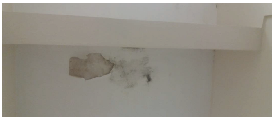
Fig.166 – Imagem fotográfica demonstrando infiltrações na laje perto das vigas. Colônias fúngicas aparentes.
