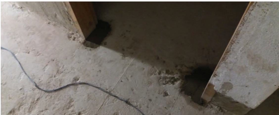
Fig.165 – Imagem fotográfica demonstrando infiltração muito forte na base das portas, o que causava um acúmulo de sujeira e colônias fúngicas aparentes, como pode-se notar em fotos dos levantamentos anteriores. Por isso, houve um a substituição de todos os batentes de todas as portas. Mas para isso, também houve um cuidado especial com a impermeabilização da base de todas elas.
