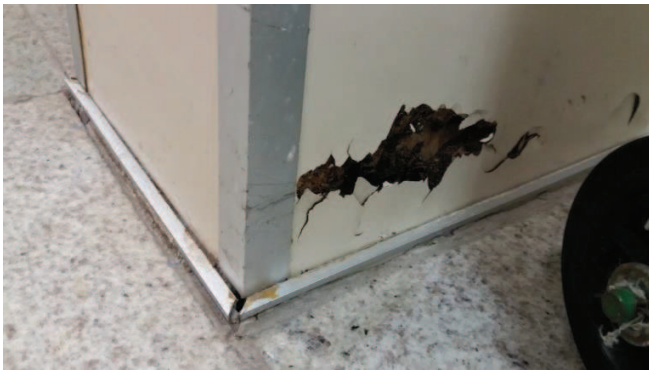
Fig.111 – Local de ponto de coleta 7: Parede Baritada – Sala de Exame Fonte: Autora, 2016
