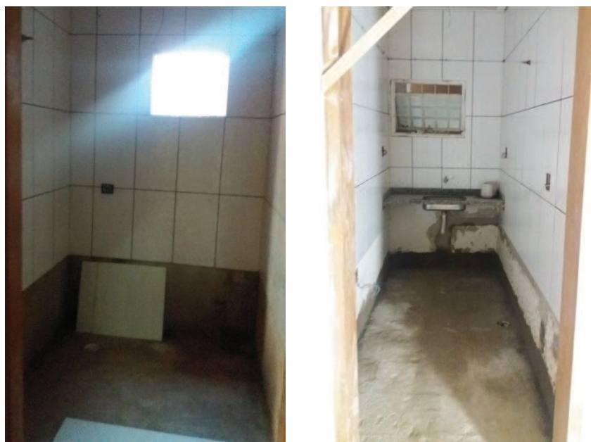
Fig.158 – Piso e contrapiso retirados. Contrapiso refeito com impermeabilizante a espera de piso cerâmico e rejunte epóxi. (banheiro) (copa) Fonte: Autora, 27 de abril de 2017.
