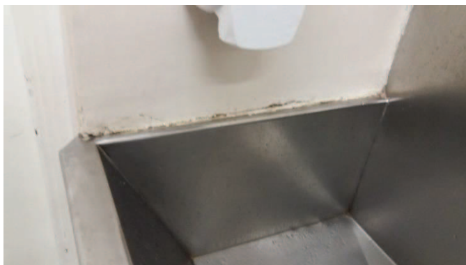
Fig.124 – Local de ponto de coleta 10: Lavatório Cirúrgico/Escovação Fonte: Autora, 2016.
