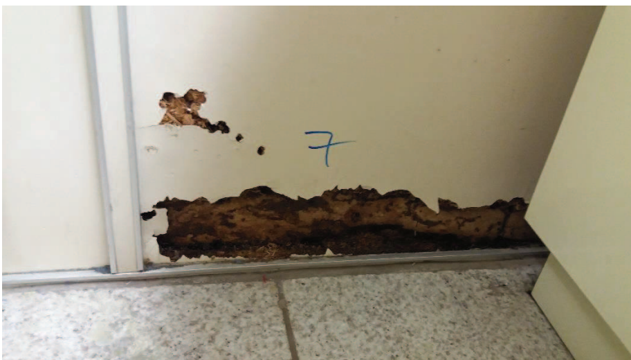
Fig.110 – Local de ponto de coleta 7: Parede Baritada– Sala de Exame Fonte: Autora, 2016
