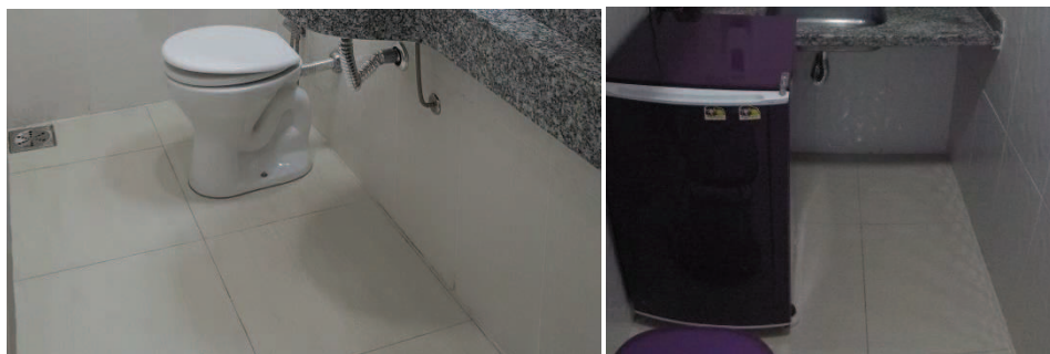
Fig.159 – Piso cerâmico e rejunte epóxi. (banheiros) (copa) Fonte: Autora, 14 de dezembro de 2017.
