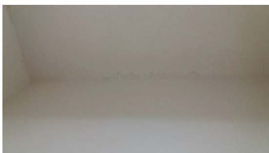
Fig.117 – Detalhes do Ponto de coleta 8: Teto infiltrado e rachado Fonte: Autora, 2016.
